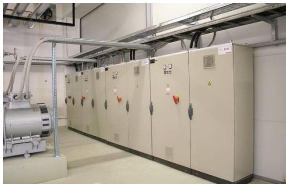
Razvodno upravljački elektro ormar
